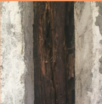
Wood rotting (wall column)
